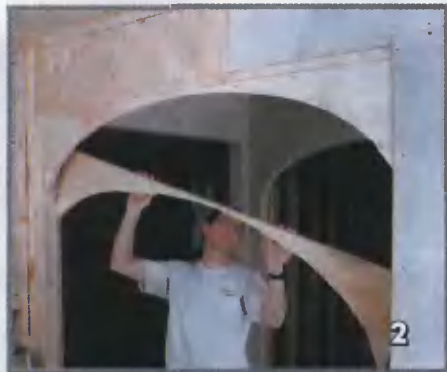
Каркас арки сделан из досок сечением 50x250 мм. К верхним концам стоек приклеены обрезки других пиломатериалов
