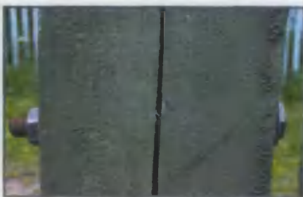
Болты стягивают створки ворот и не дают им деформироваться
