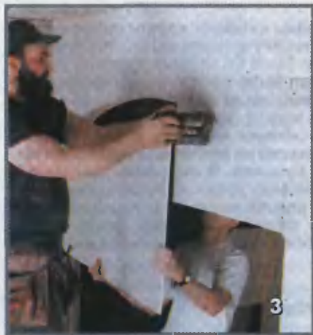
Здесь точность не нужна. Сухую штукатурку толщиной 12,5 мм крепят к обеим сторонам арки с припуском, а потом обрезают с помощью фасонно-фрезерной машинки
